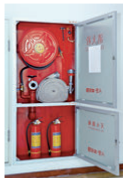
图7-8 建筑物内的消防设施
